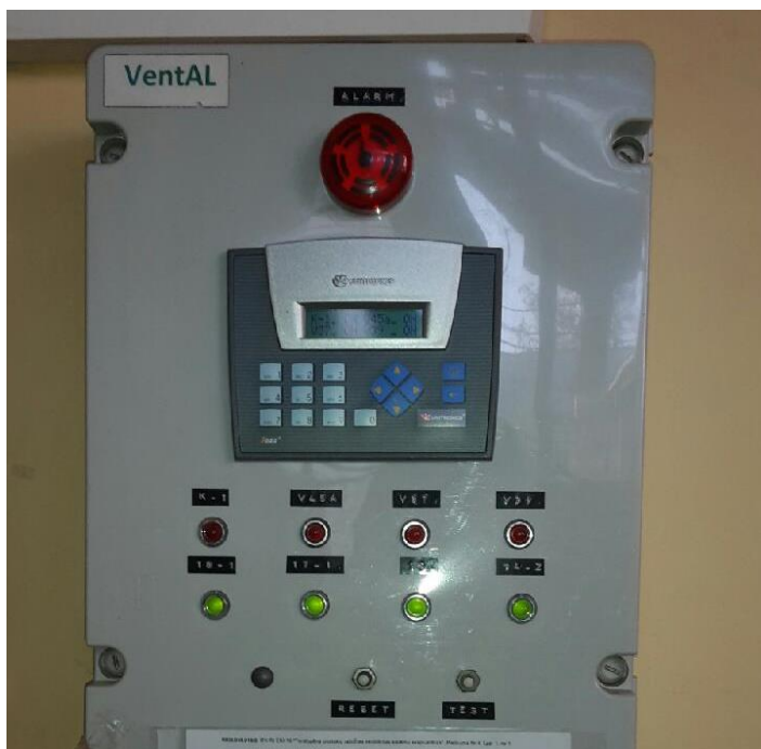
Ventilācijas darbības kontroles sistēma VentAL 22. korpusā
