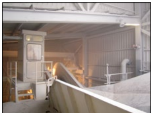
Iekārtu operatora uzraudzības posteņa kabīnē ar ventilāciju ir būtiski mazāka putekļu koncentrācija
