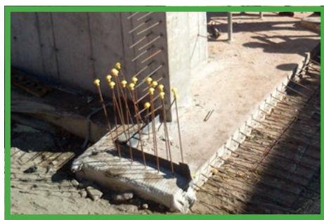
Drošības zonu norobežošana, brīdinājuma zīmju izvietošana, aso armatūras galu nosegšana samazina nelaimes gadījumu riskus
