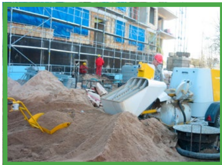
Automatizēta smilts padeve līdz betona maisītājam ievērojami samazina darba slodzi
