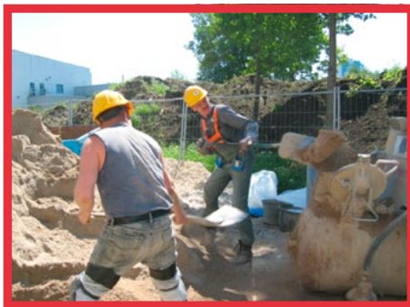
Ar rokām veicot betona javas sajaukšanu, nodarbinātajiem jāpārcilā daudzas tonnas smilšu un cementa
