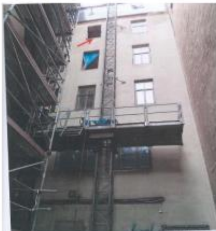
1. Skatoties. Platforma MA1200 ar reģistrāciju Nr. 203020079. Ar kāju, kas ir uzlika uz palodzes, cietušais noņēma kāju no pacelāja un uzlika to uz pārlikto finiera loksni.
