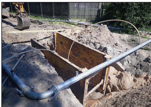
Darbs tranšeju tuvumā un tranšejās ir īpaši bīstams zemes nogruvumu dēļ
