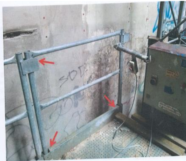
4. fotoattēls. Platformas MA1200 margu posms, kas bija izņemts maisu izkraušanas darbības laikā, kad platforma atradās 5. stāva loga ailes līmenī. Margu posms ir viegli noņemams pēc vajadzības.
