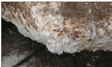
Bojāta azbestu saturoša siltumizolācija
