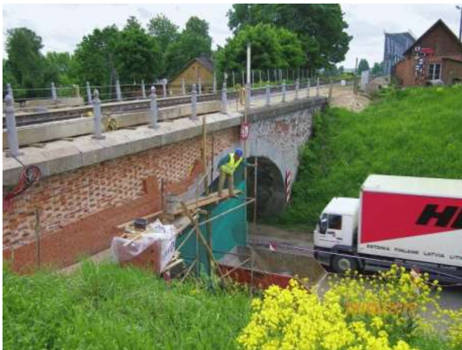
Valsts darba inspekcijas apturētu būvdarbu veikšanai izmantotas sastatnes. Foto - VDI
