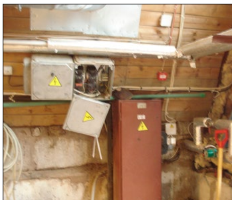
Valēji un bojāti elektrības sadales skapji var izraisīt sprādzienu vai ugunsgrēku
