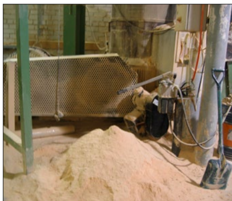
Putekļu kaudzes darba vietās, kur iespējami aizdegšanās riski, var izraisīt sprādzienu vai ugunsgrēku
