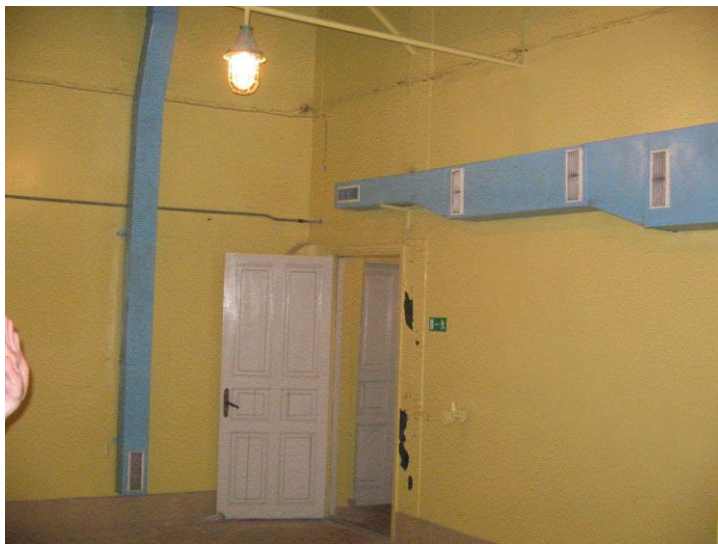
Ventilācijas sistēma sprādzienbīstamā telpā.
