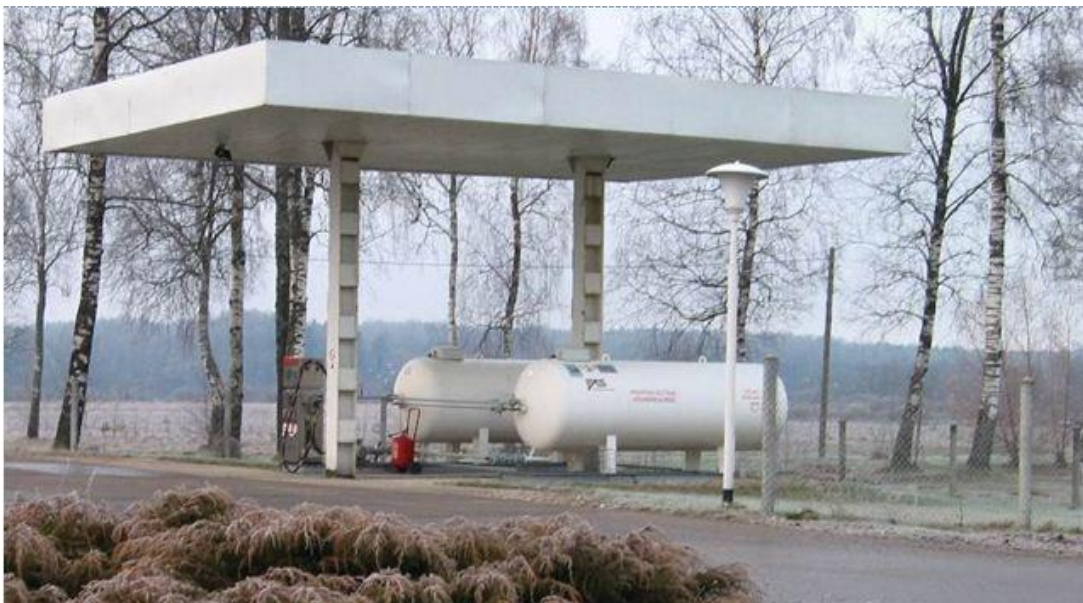
5. PIEMĒRS. Tehniskās iekārtas degvielas un gāzes uzpildes stacijās.
