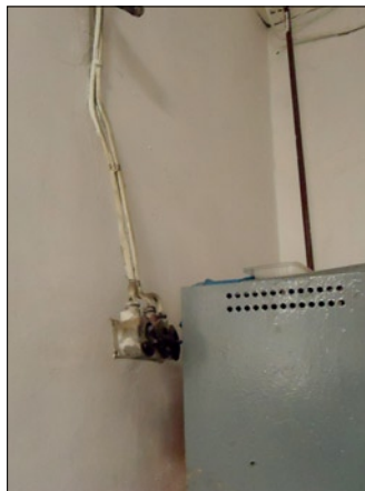
Bojāti kontakti var būt elektrotraumu iemesls nodarbinātajiem, tie rada arī sprādzienbīstamības un ugunsdrošības risku
