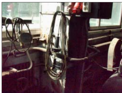
Valējas kvēlspludzes izmantošana autoservisa darbos var izraisīt sprādzienu vai ugunsgrēku
