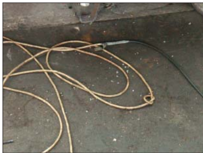
Vadus un kabeļus nevajadzētu izvietot vietās, kur pārvietojas nodarbinātie
