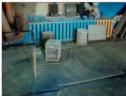
Elektrosildītāji ar atklātu spirāli telpā, kur notiek automašīnu krāsošana, var izraisīt ugunsgrēku
