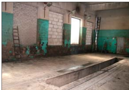
Nenosegta remonta bedre, kā arī bojātas koka pārvietojamās kāpnes ir bīstamas
