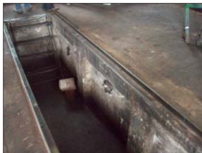
Nedrošas kāpnes iekāpšanai auto remonta bedrē rada kritienu risku
