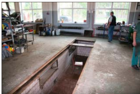
Paklupšanas risku rada kāpšana pāri remonta bedrei vai nedrošas pārejas izmantošana
