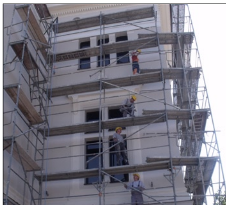
Sastatņu montāža nav pareiza, ja tā notiek vienlaicīgi vairākos stāvos
