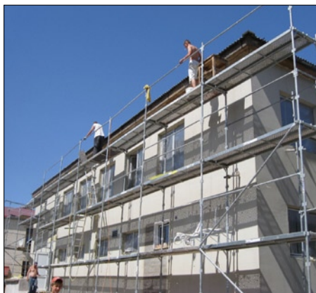
Noteikumu prasībām neatbilstošas ir sastatnes, kurām nav nodrošinātas kājlietes, kā arī trūkst vidus margu
