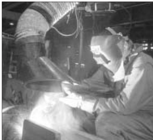
3.21. attēls. Elektrometināšanas darbos, kur ir saskare ar svinu, nepieciešama vietējā un vispārējā ventilācija
